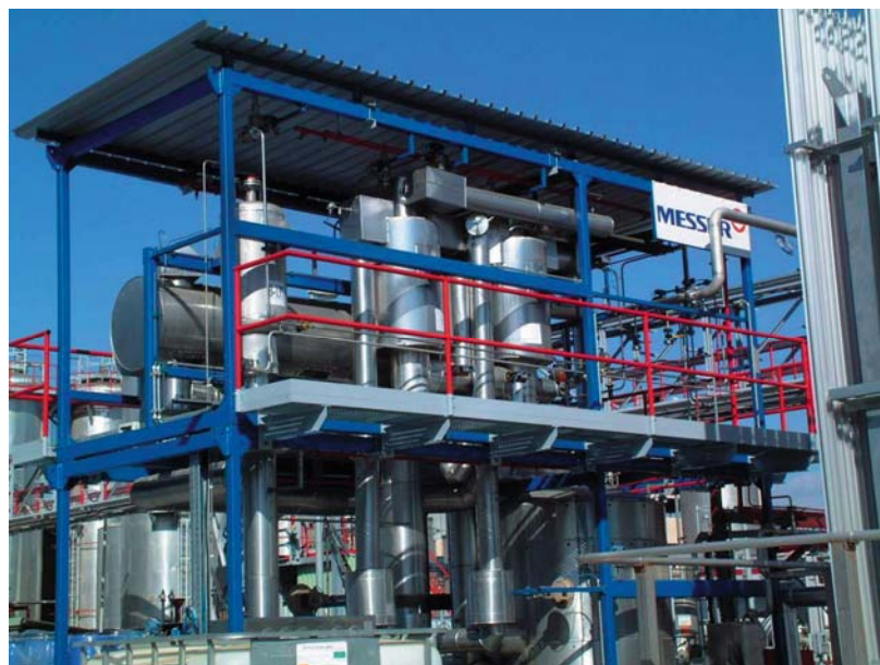
3. ábra. Cryosolv berendezés metil-klorid visszanyerésére -- Goldschmidt Espana, Barcelona
