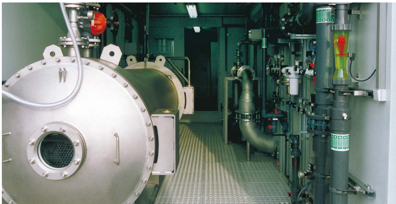
8. ábra: Ózongenerátor-berendezés részleges oxidációjához. (Fotó: Wedeco)
