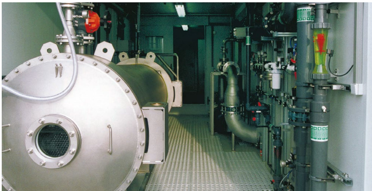
8. ábra: Ózongenerátor-berendezés részleges oxidációjához. (Fotó: Wedeco)
