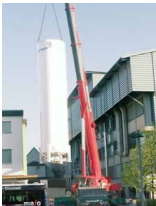
A nitrogéntartály telepítése a Zeiss üzemenél.
